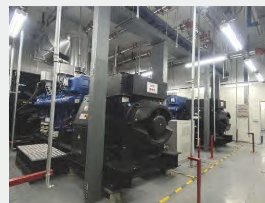
■ 中国电信兰州新区大数据产业园
