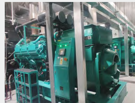
■ 上海七宝数据中心
